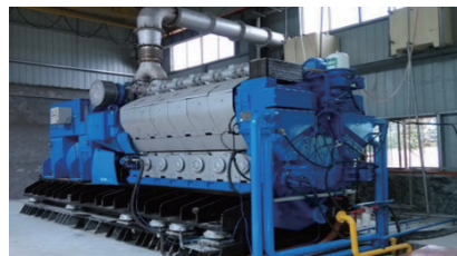
孟加拉天然气发电项目
